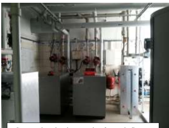
Centrala ciepła – „kotłownia”.
